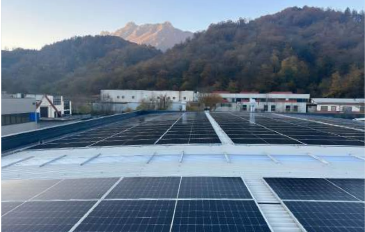
L'impianto fotovoltaico sovrastante la sede di Dnd, a Casto. The photovoltaic system above the Dnd headquarters in Casto.
